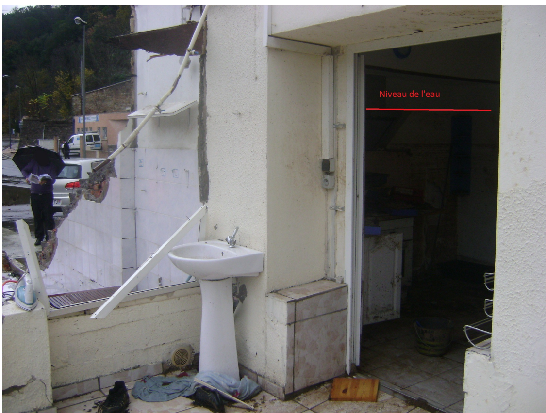
Illustration 20: Niveau atteint dans le bâtiment
