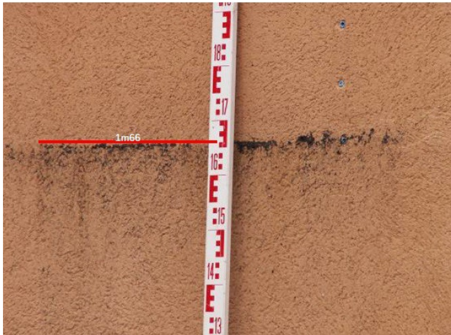
Illustration 16: Relevé des laisses de la crue – Rue des Yeuses
