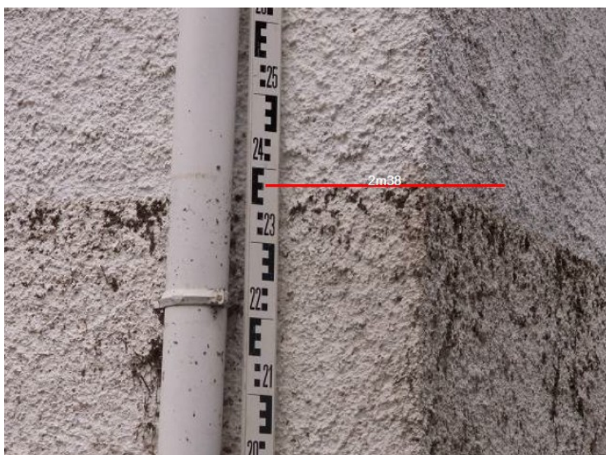
Illustration 19: Relevé des laisses de la crue – Rue des Acacias
