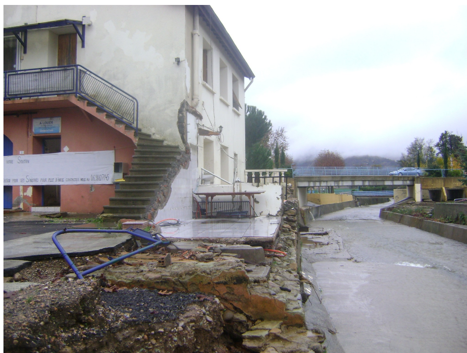
Illustration 22: Dépendance et terrasse emportées par la crue
