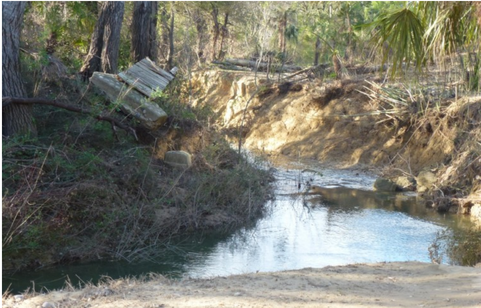
Illustration 3 : Érosion des berges du Rouviège au niveau du Mas de Bussac (Source : auteurs)
