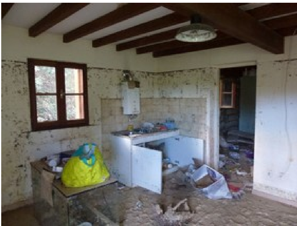
Illustration 23 : laisse de crue à l'intérieur de la maison suite à l'évènement du 29 septembre (Source : auteurs)
