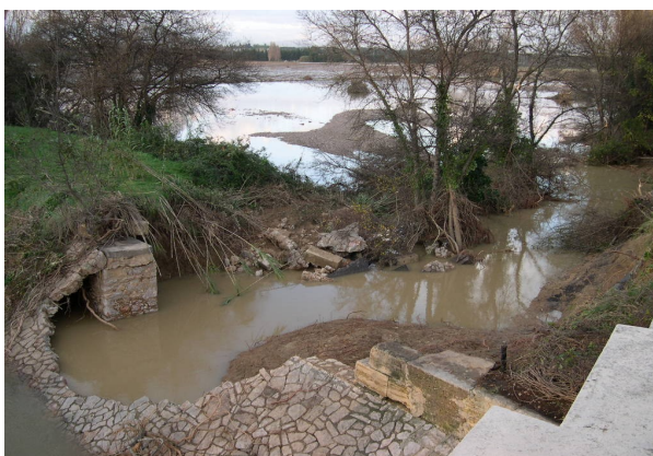
Dégâts sur une digue (Mosson - 12/2003 - photo DDTM)
