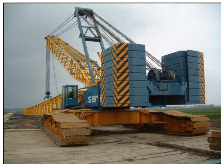
Photographie 19: Photo de la grue permettant l'assemblage des différents éléments d'une éolienne
