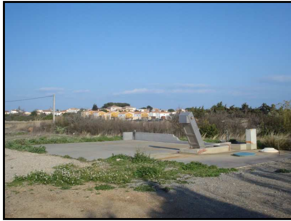
Vue du poste de refoulement et de son dégrilleur
