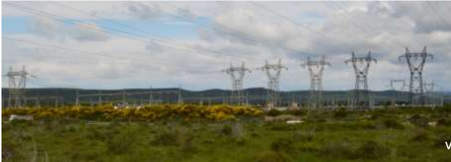
Vue du Poste Electrique depuis le Terrain du Projet
