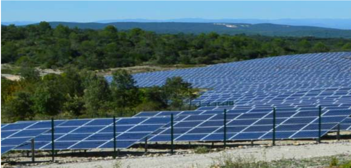
Clarensac Solar (Gard) – vue des assemblages de panneaux et des clôtures
