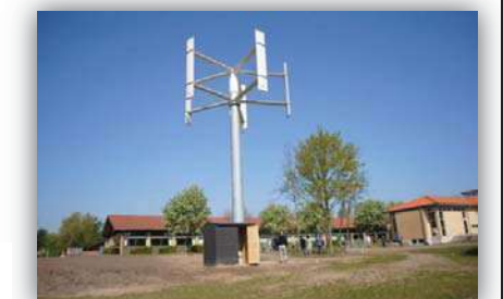
Éolienne Darrieus de 6 kW
