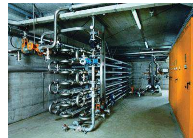
Figure 23 : Echangeur tubulaire en sortie de STEP (Lyonnaise des Eaux, ISTINOX, ANTEA)
