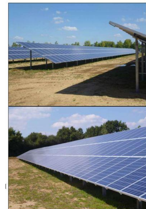
Figure 11 : Exemples de champs solaires panneaux fixes et pieux battus
