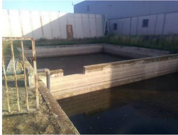
Figure 3 : Bassin lixiviats de la plateforme de compostage.
