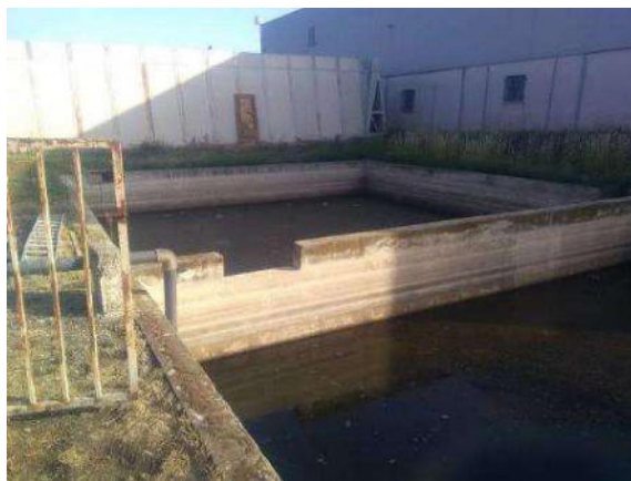
Figure 3 : Bassin lixiviate de la plateforme de compostage.
